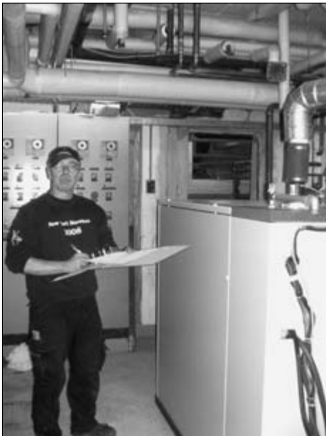
Uwe Eck vor dem neuen Blockheizkraftwerk
