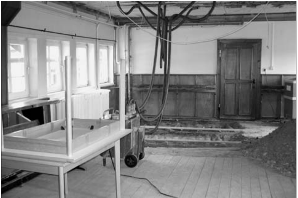
Wasserschaden im Landgrafenzimmer
